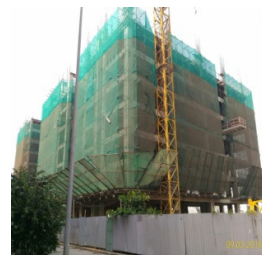
Block K3 (diện tích: 14.008,10m 2 , 15 tầng): hoàn thiện phần khung, bê tông cốt thép (cột, sàn) đến tầng 7.
